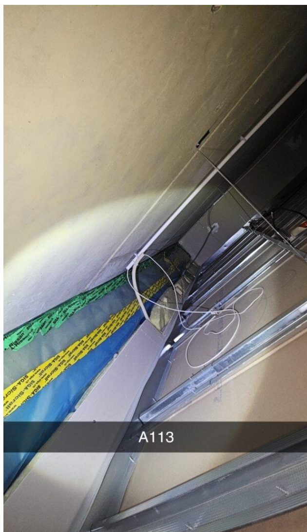
Figur 1: Gips ikke tilstrekkelig tilsluttet opp mot tak
