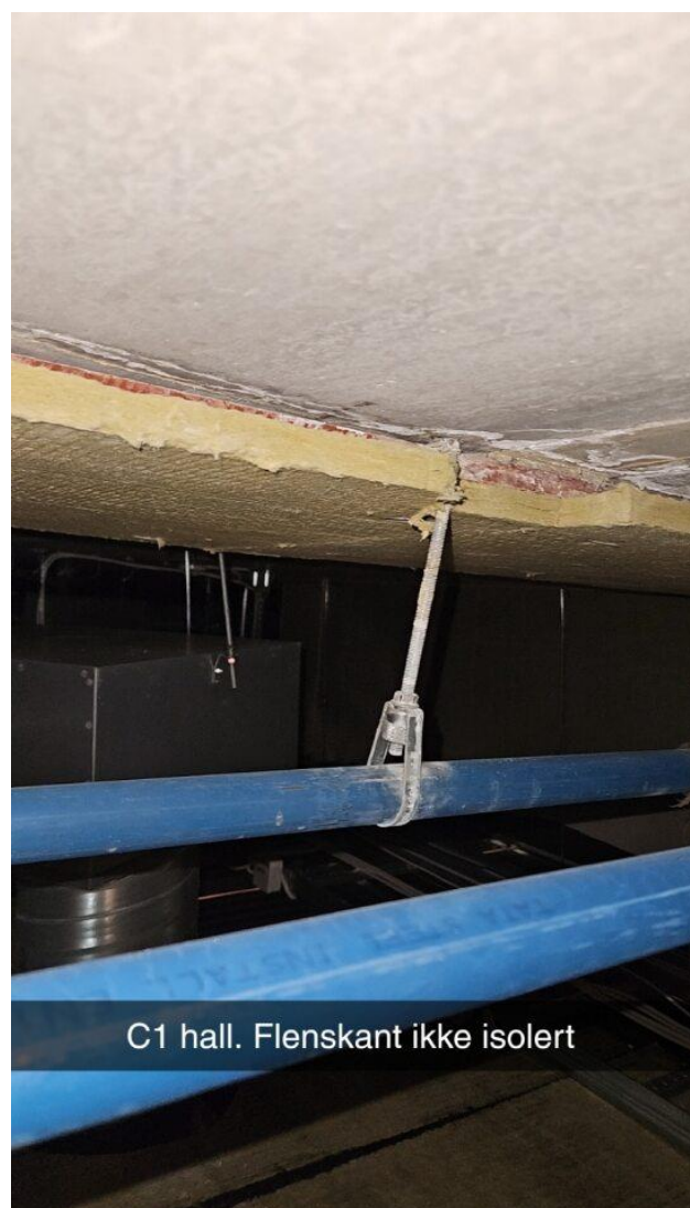
Figur 2: Mangelfull brannisolasjon av stålbein
