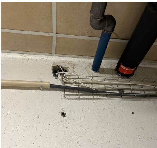
Figur 5 Åpne kabelgjennomføringer til rom Vifterom B.U.11.1
