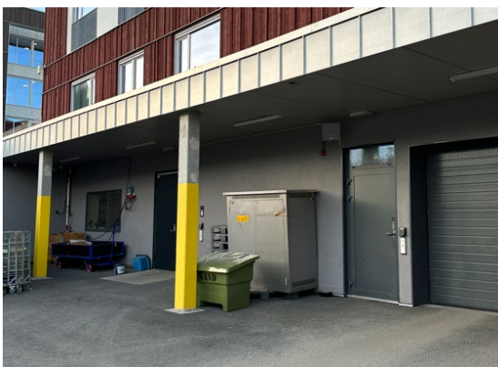
Figur 9 Skap merket brennbar gass plassert nær uklassifisert garasjeport og -dør
