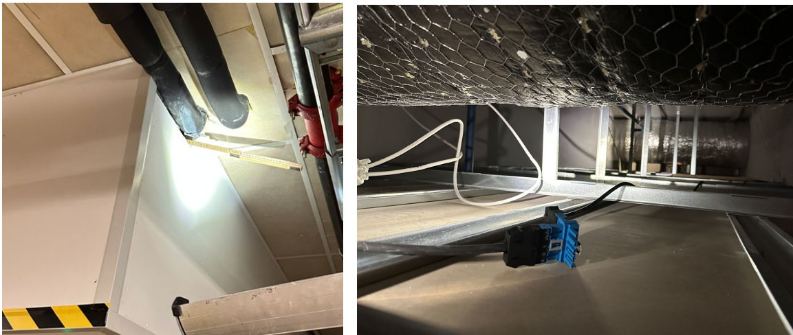
Figur 7 Glippe i gips og manglende isolasjon i innkassing for ventilasjonskanaler
