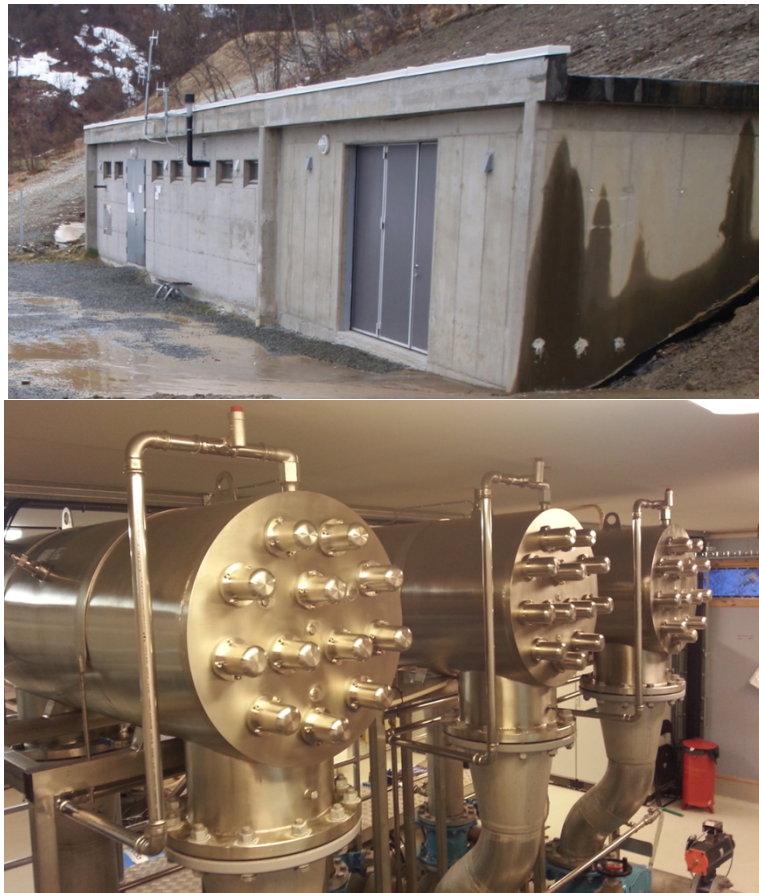
Figur 11: Kvaløya Vannbehandlingsbygg (øverst) med eksisterende UV-aggregat (nederst).
